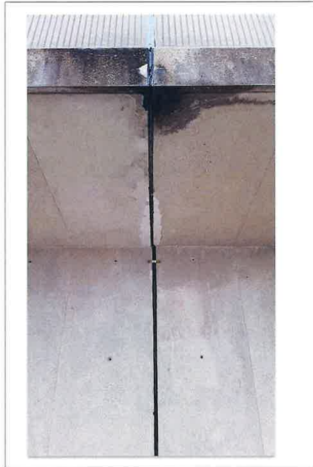
Bild 3-4: Wasserschaden am Kragarmkopf der Winkelstützwand (Foto 07.01.2021)
