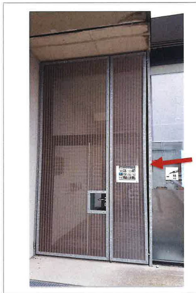
Bild 3-2: Verformungen im Eingangsbereich (Foto 07.01.2021)
